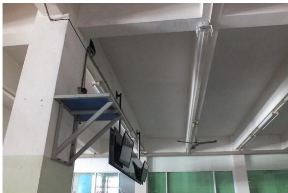
จุดติดตั้ง AP
