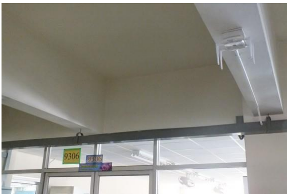
จุดติดตั้ง AP
