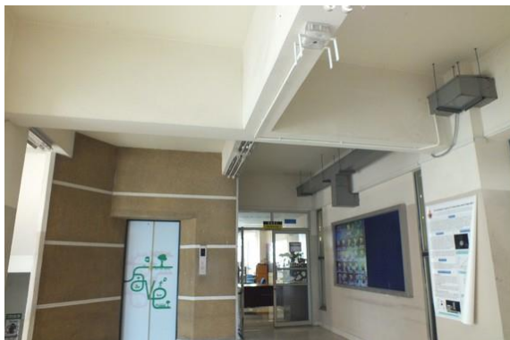
จุดติดตั้ง AP
