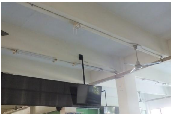
จุดติดตั้ง AP
