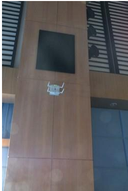
จุดติดตั้ง AP
