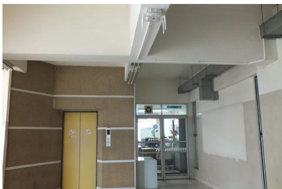
จุดติดตั้ง AP
