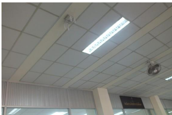
จุดติดตั้ง AP
