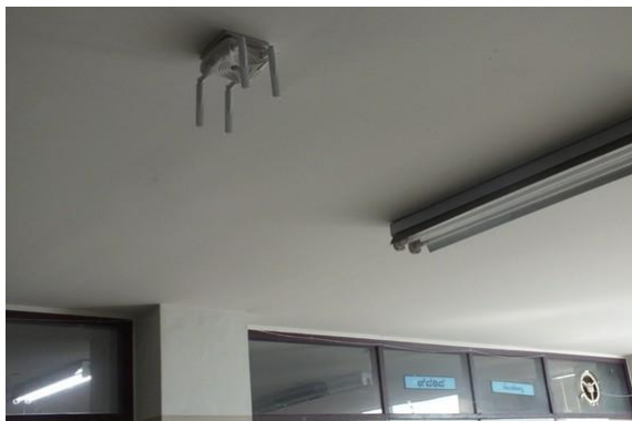
จุดติดตั้ง AP
