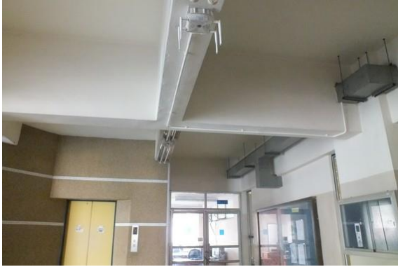
จุดติดตั้ง AP
