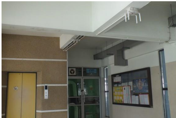
จุดติดตั้ง AP
