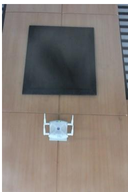
จุดติดตั้ง AP
