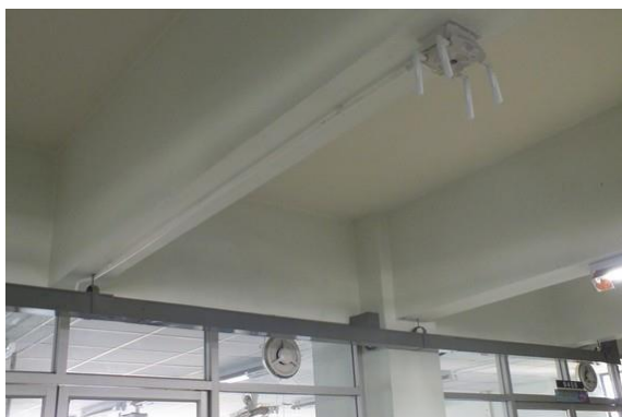
จุดติดตั้ง AP
