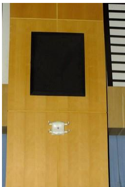
จุดติดตั้ง AP
