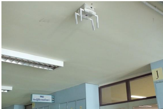
จุดติดตั้ง AP
