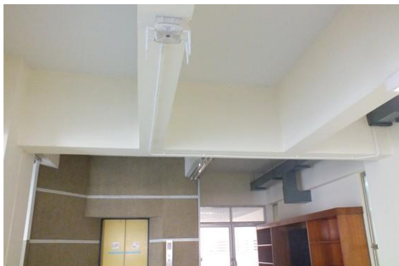
จุดติดตั้ง AP
