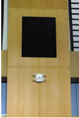
จุดติดตั้ง AP
