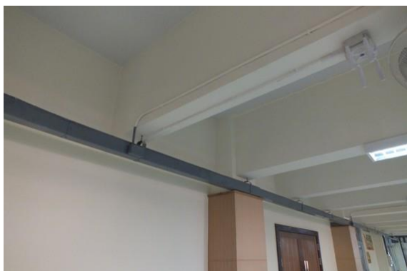
จุดติดตั้ง AP
