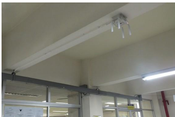
จุดติดตั้ง AP
