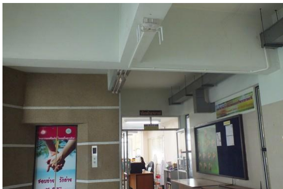
จุดติดตั้ง AP
